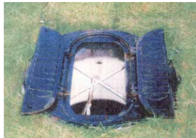
災害用トイレマンホール
