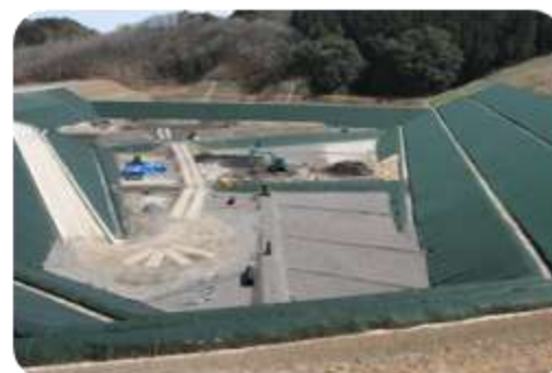
埋立処理施設（41施設）
