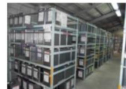
【石油缶ラックの落下防止柵】
